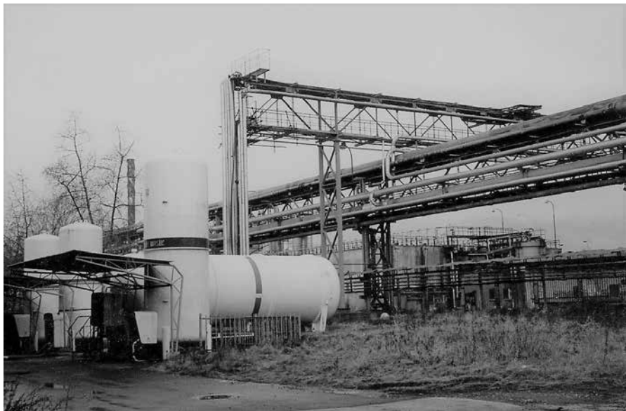
Izolované zásobníky dusíku (foto K. Walter)
